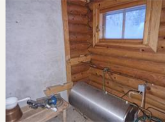
sauna/ph lämminvesivaraaja ja laudepaikka
