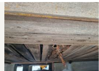
WC-saunan pukuhuoneen rossipohjan vuoto/korjaustarve
