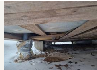
Keittiön rossilattia alapuoli, puuttuu laudoitus ja osin eristys
