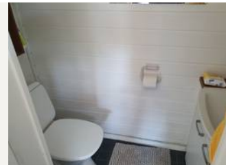
kv huoneen wc
